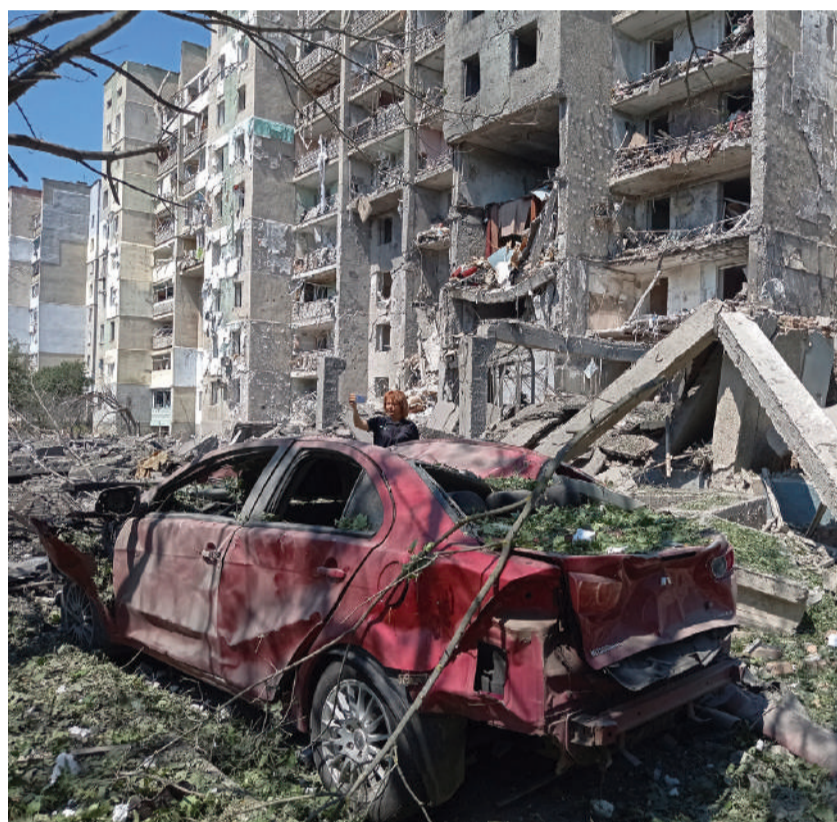
UNA TOMA GENERAL muestra el daño causado por un ataque con misiles rusos, a una zona residencial, en el pueblo de Serhiivka.
