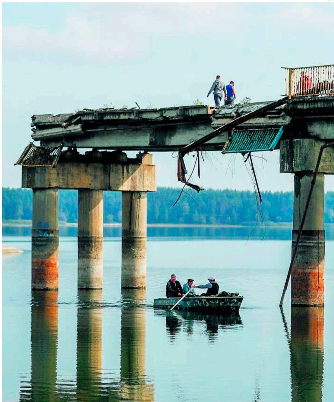
Civiles atraviesan en un bote el río siverskyi en Donetsk bajo el principal puente destruido por la guerra
