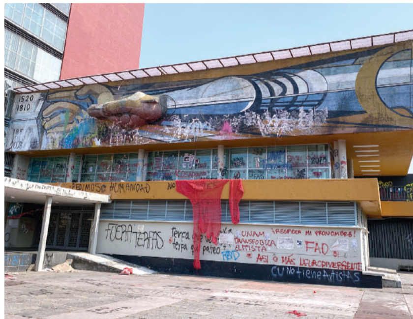
LA OBRA de David Alfaro Siqueiros, tras el ataque de los encapuchados.
