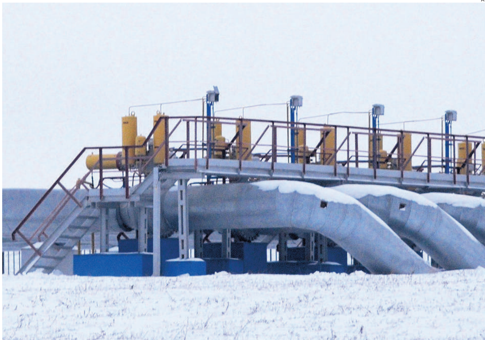
La estación de bombeo de gas en Sudzha, Rusia, tomada por las tropas de Ucrania en la incursión
