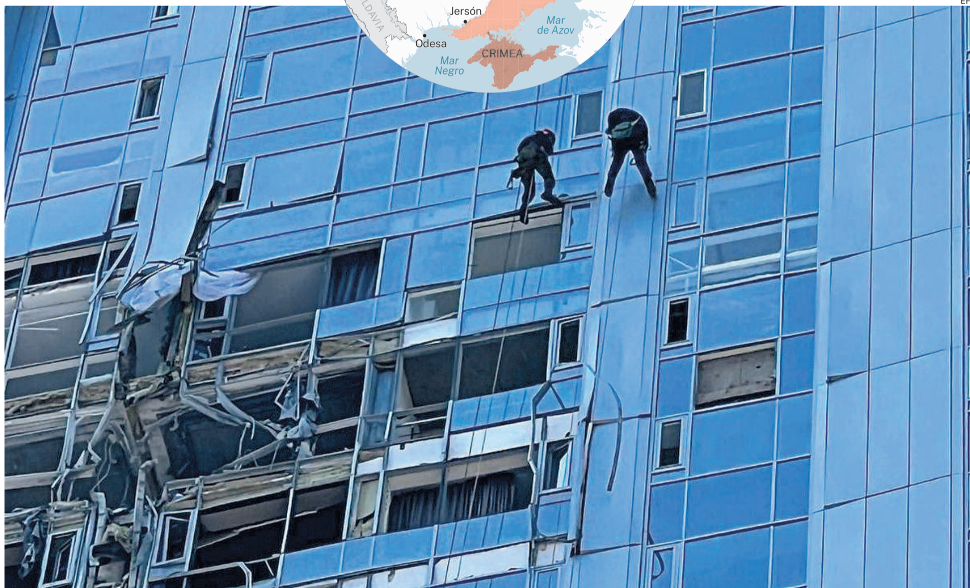
Daños en la fachada de un edificio comercial en Saratov (Rusia) por el ataque de drones ucranianos, ayer
