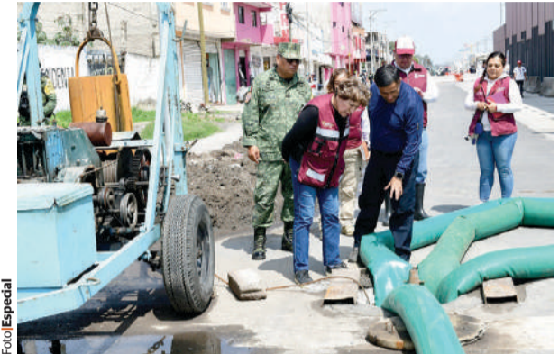
DELFINA Gómez, durante la supervisión de las obras para reducir los niveles de agua en calles de Chalco, ayer.
