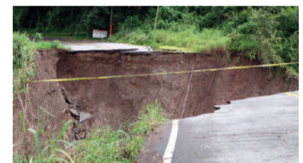
SOCAVÓN en la carretera México-Acapulco, en Chilpancingo, ayer.
