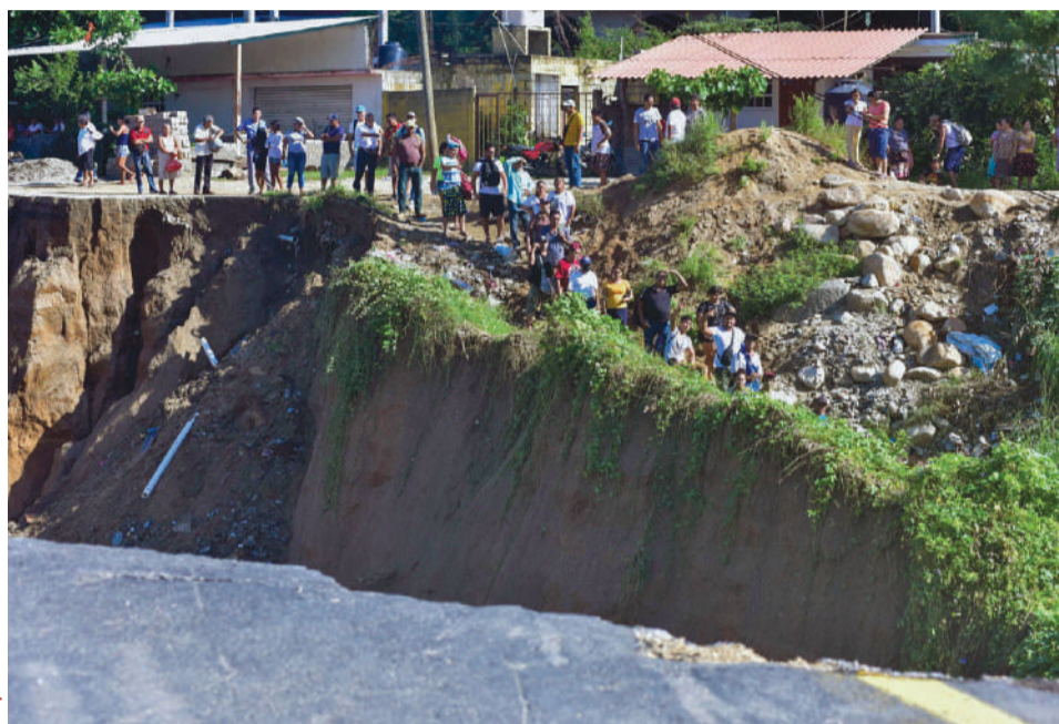
POBLADORES de la zona rural de Acapulco, quienes quedaron incomunicados al colapsar el puente de la carretera federal, en el kilómetro 21, pidieron apoyo a las autoridades, ayer.
