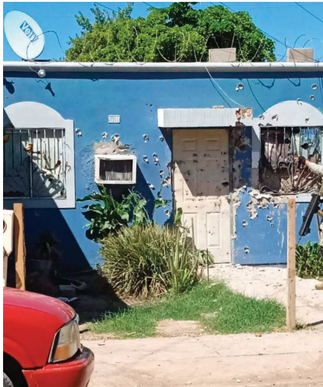
ASÍ QUEDÓ la fachada de una casa tras las balaceras del 22 de septiembre en Ciudad Obregón.
