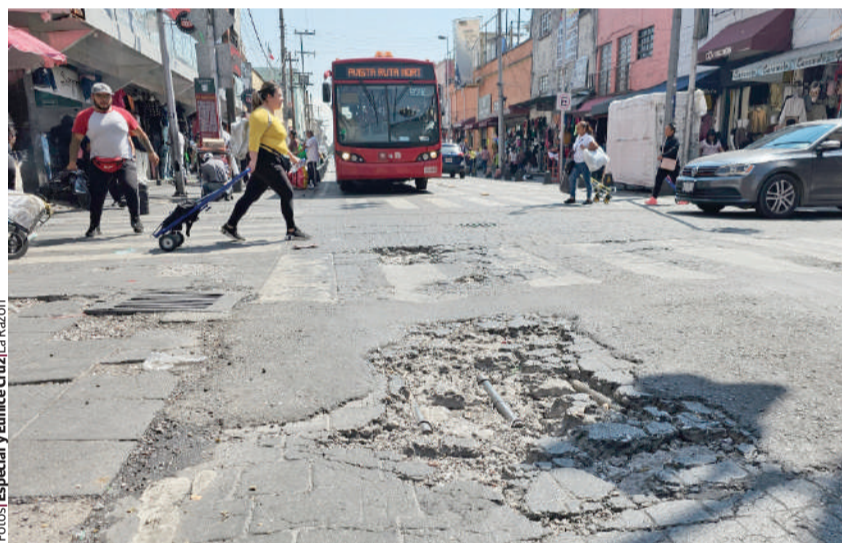
BACHE en la calle República de Venezuela en la zona centro de la capital, ayer.
